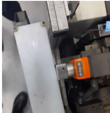
Figura 35 – Manípulo impedindo fechamento da porta de proteção
