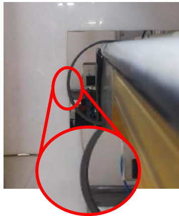
Figura 30 – Anel de 160 milímetros de diâmetro apresentando restrições no sistema de abastecimento
